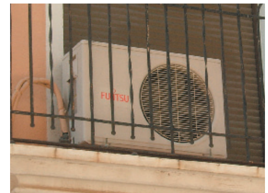
7. Extractor de aire acondicionado.
