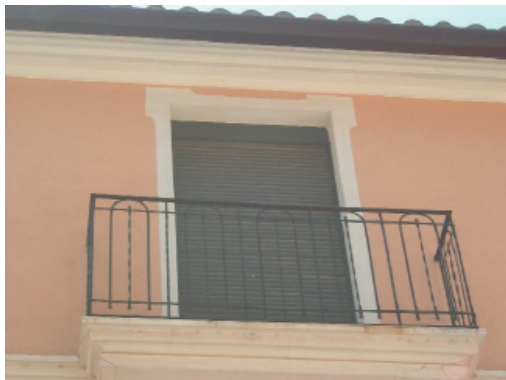
1-2-5. Alero, fenestración y canalón de acero galvanizado.
