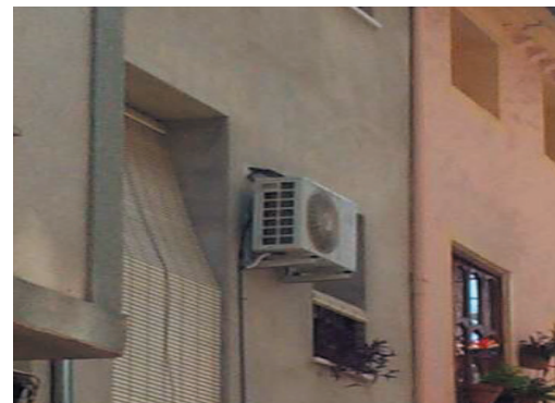
6. Aparato aire acondicionado
