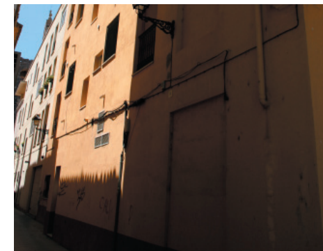
7-8. Cables de instalaciones. Bajantes y canalón de acero galvanizado.
