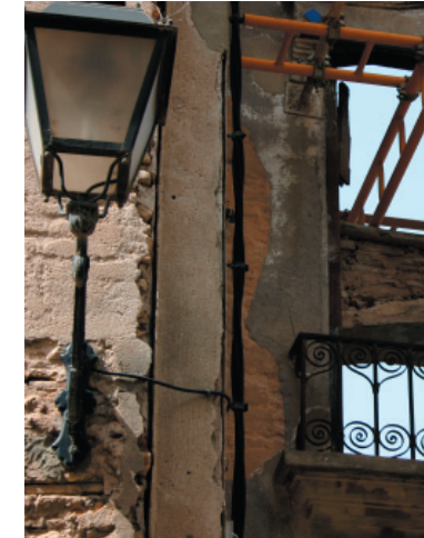
8. Cables de instalaciones.
