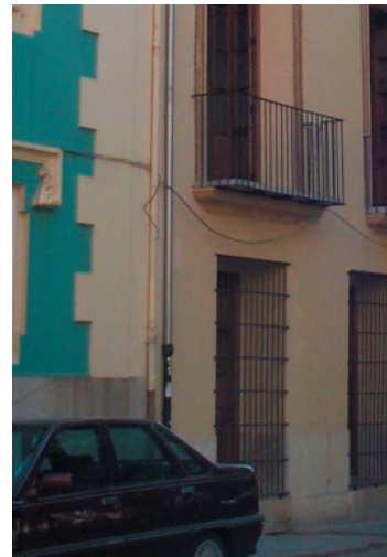
8. Bajante de fundición
