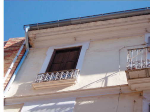
6. Canalón de acero galvanizado.
