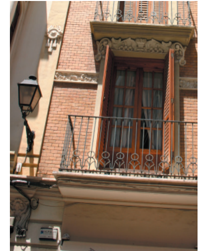
7. Presencia de cableados.
