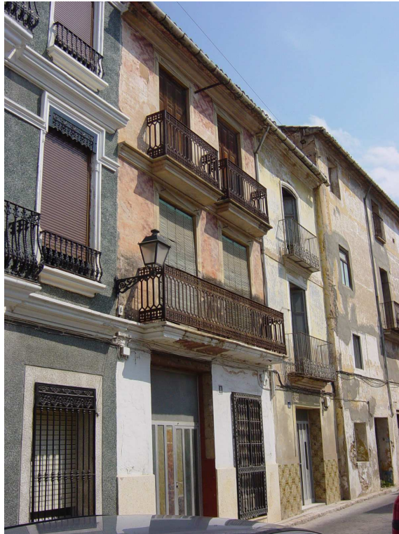
M4/13. Tipología de edificación tradicional transformada. Nuevo elemento protegido por el Catálogo de Bienes y Espacios Protegidos d'Alzira.
