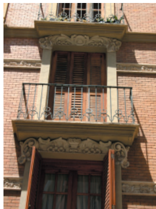
2-6. Recercado de huecos en el cuerpo central e izquierdo de la fachada ppal. Rejerías de forja.
