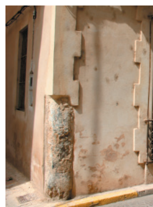
11-12. Remate en esquina de piedra. Umbral y guardacantó en la puerta de acceso de piedra
