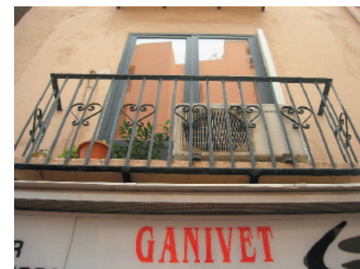
3-7. Carpintería de hierro. Extractor de aire acondicionado.
