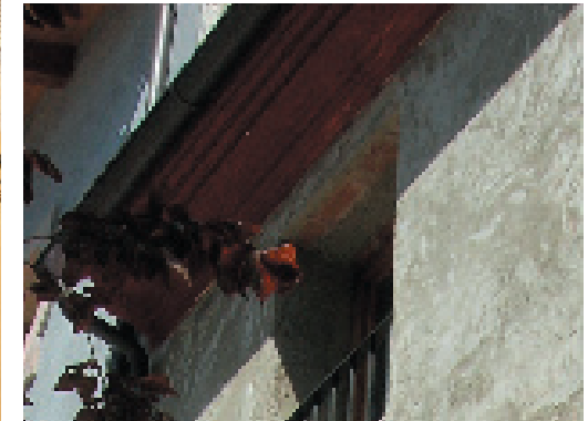
6. Canalón de acero galvanizado.
