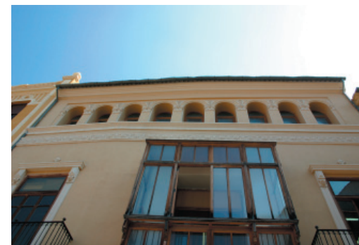
2-3-7. Composición de fachada con galería superior de arcos de medio punto. Mirador. Y canalón de acero galvanizado
